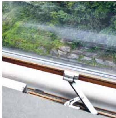
Automatische Fensterlüftung auf der Ost- und Westfassade (2. und 3. Geschoss)
