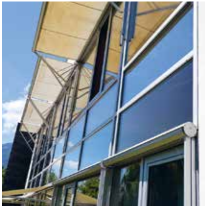
Thermische Solaranlage für Brauchwarmwasser und Heizungsunterstützung
