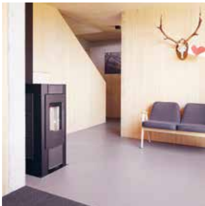
Pelletofen im Eingangsbereich
